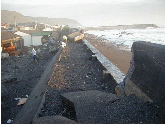
〔菜生海岸被災状況（室戸市）〕
