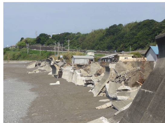
〔穴内海岸被災状況（安芸市）〕
