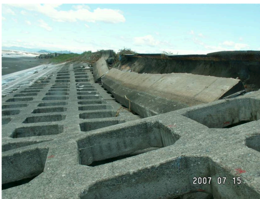
〔吉川海岸被災状況（香南市）〕
