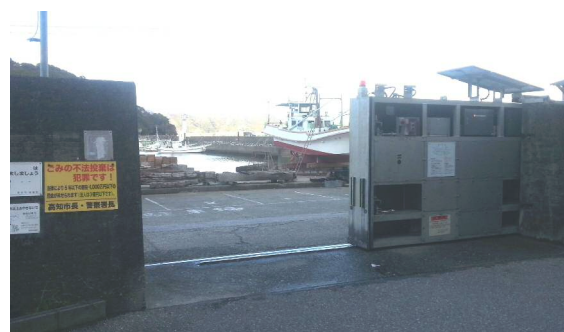
〔陸閘機械化 事例〕
