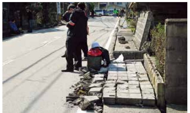
能登半島地震 倒れたブロック塀=石川県輪島市 (平成19年3月26日 / 提供: 一般財団法人 消防科学総合センター)
