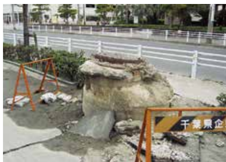
地面の液状化によるマンホールの隆起＝千葉県浦安市(提供:一般財団法人消防科学総合センター)
