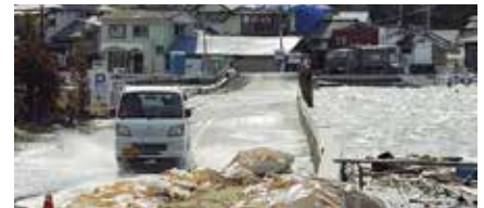
地盤沈下で低くなり、大潮の満潮で冠水した道路を走る車 = 宮城県東松島市 (提供: 共同通信社)
