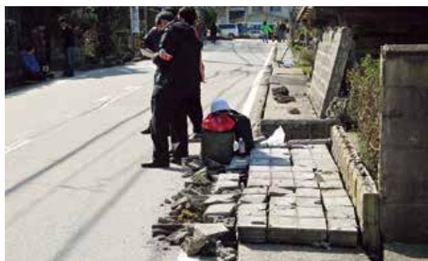
能登半島地震 倒れたブロック塀=石川県輪島市 (平成19年3月26日 / 提供: 一般財団法人 消防科学総合センター)
