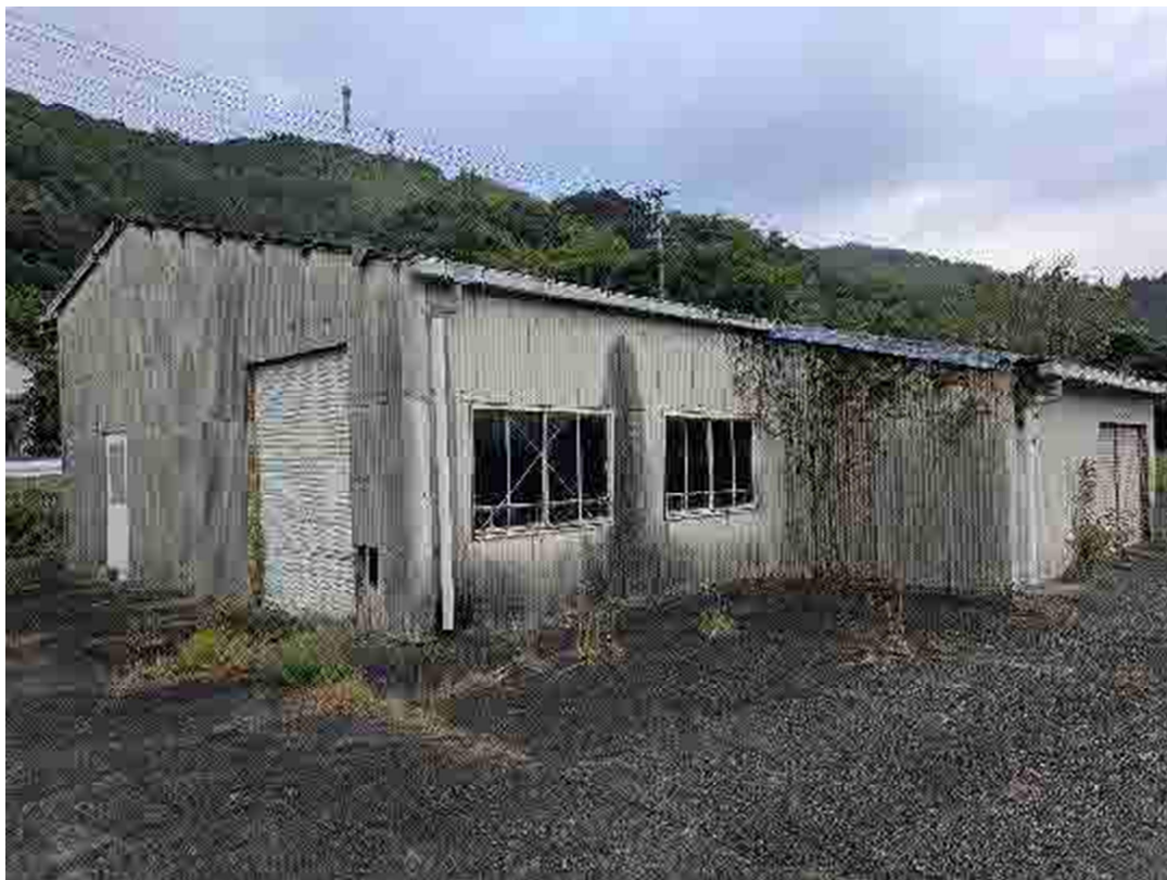
【建物老朽化④】
