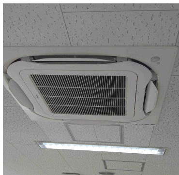
幡多看護学校の空調設備
