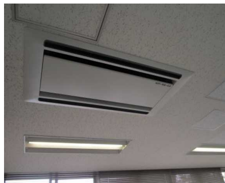
農業技術センターの空調設備
