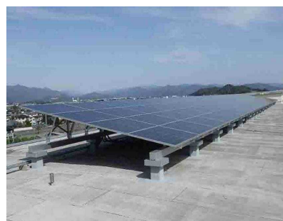
岡豊高校の太陽光発電設備
