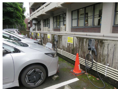
充電設備の整備
