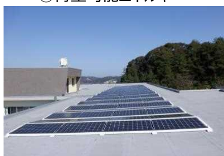
太陽光発電設備整備事業
