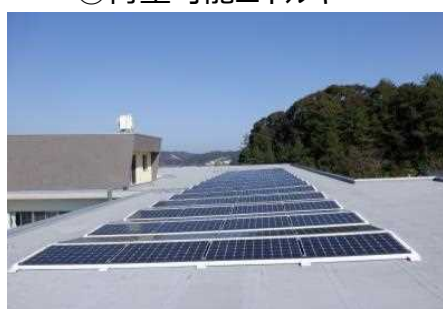
太陽光発電設備整備事業
