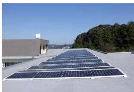
太陽光発電設備整備事業
