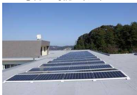
太陽光発電設備整備事業
