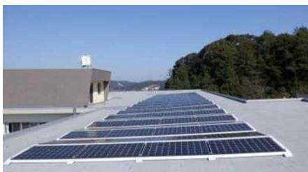
太陽光発電設備整備事業
