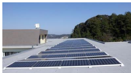
太陽光発電設備整備事業
