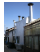
ペレットボイラ 機械室
