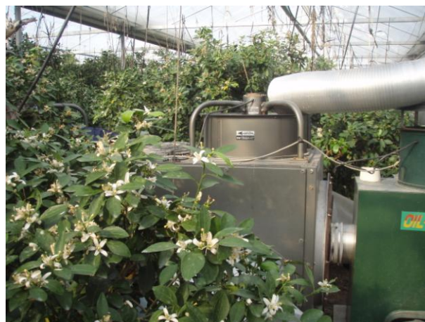
排熱回収装置
