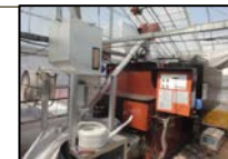
木質バイオマスボイラー
