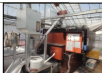
木質バイオマスボイラー
