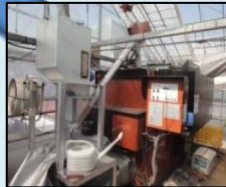
木質バイオマスボイラー
