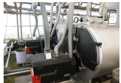
木質バイオマスボイラー
