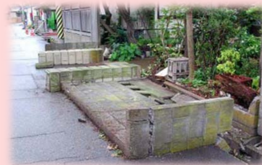
地震により倒壊したブロック塀 (平成19年新潟県中越沖地震)
