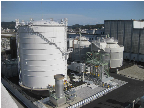
消化施設（高須浄化センター）
