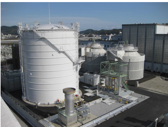
消化施設（高須浄化センター）
