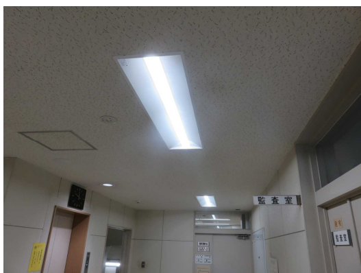
LED 照明設備（県庁北庁舎）
