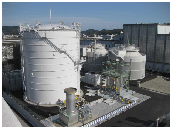
消化施設（高須浄化センター）
