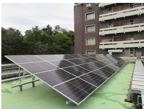
太陽光発電設備（県庁本庁舎）
