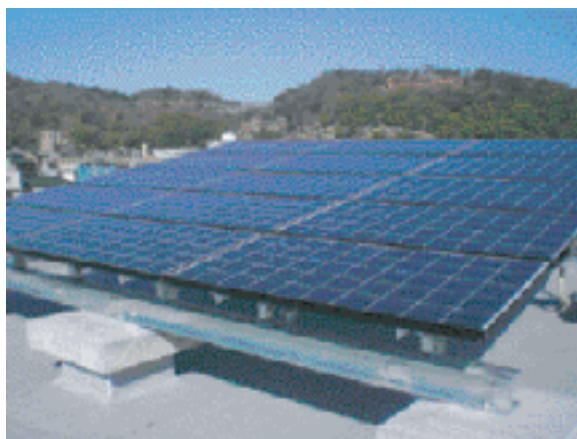
太陽光発電設備
