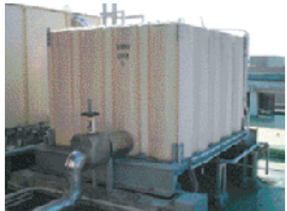
雨水再利用高架水槽（本庁舎屋上）
