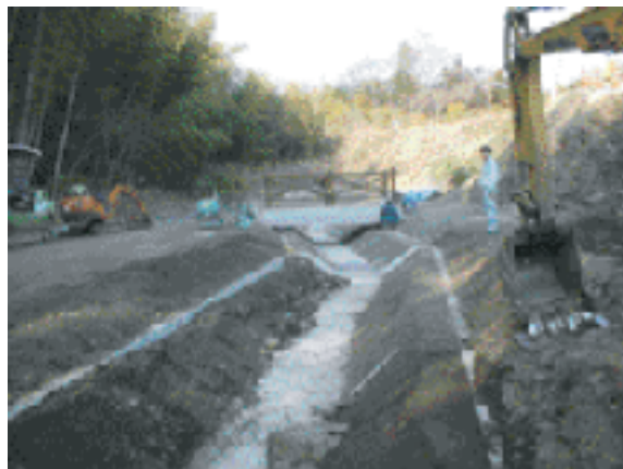
竹炭を用いた水質浄化設備
