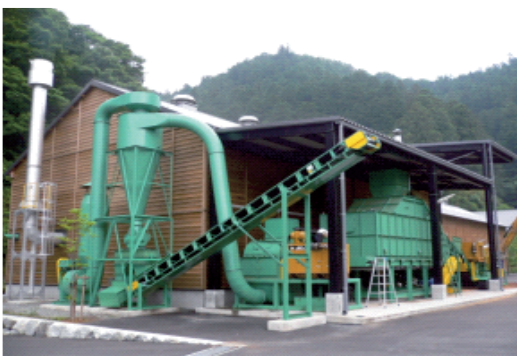
木質バイオマスを利用したペレット製造施設（梶原町）
