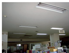
照明の間引き (伊野合同庁舎)
