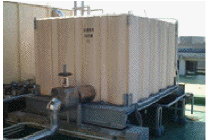
雨水利用高架水槽（本庁舎屋上）
