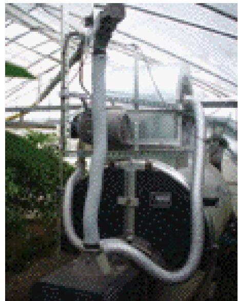
木質ペレットボイラー（南国市東崎）
