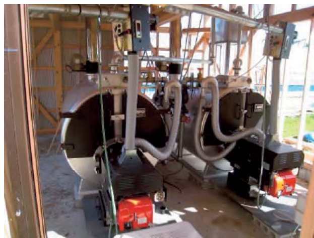
施設園芸用の木質ペレットボイラー (四万十町興津)
