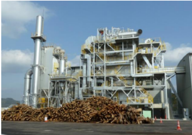
木質バイオマス発電施設（宿毛市平田）
