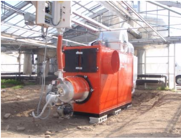
木質ペレットボイラー（南国市長岡）
