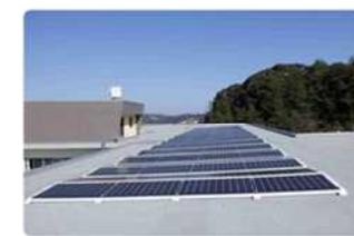
▲太陽光発電設備整備事業
