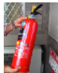
消火器・資機材の点検
