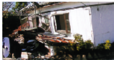
新潟県中越地震による家屋倒壊（新潟県長岡市）
