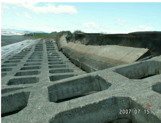
〔吉川海岸被災状況（香南市）〕
