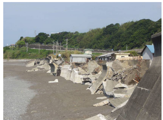
〔穴内海岸被災状況（安芸市）〕
