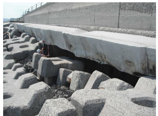
〔長浜海岸被災状況（高知市）〕
