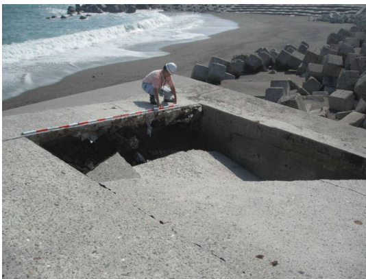
〔戸原海岸被災状況（高知市）〕
