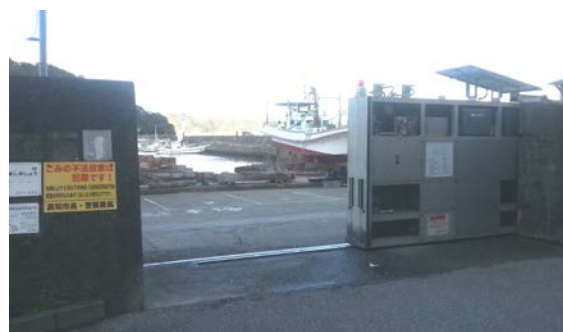
〔陸閘機械化 事例〕
