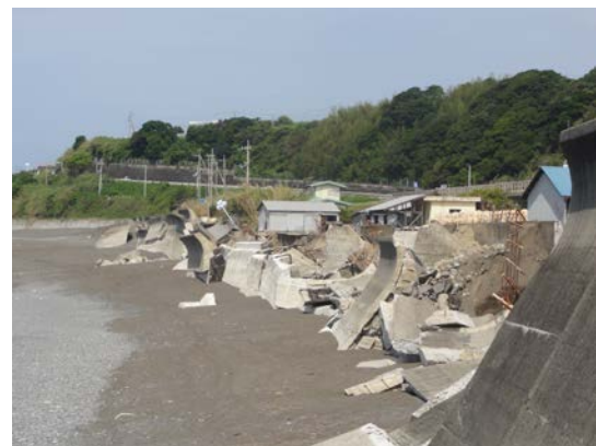
〔穴内海岸被災状況（安芸市）〕
