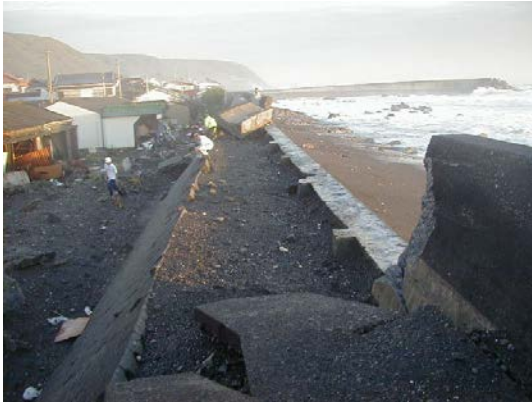
〔菜生海岸被災状況（室戸市）〕
