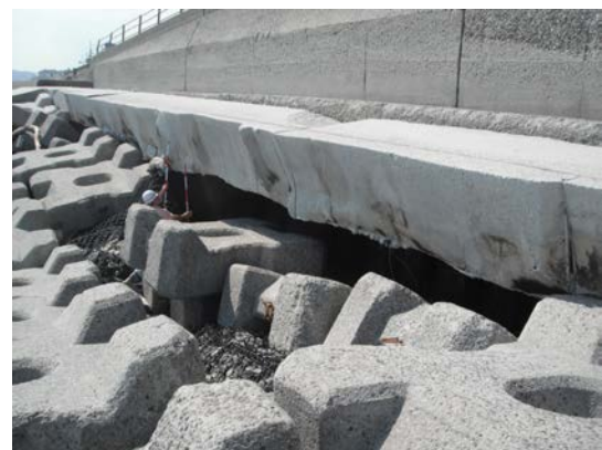
〔長浜海岸被災状況（高知市）〕
