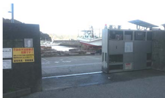
〔陸閘機械化 事例〕
