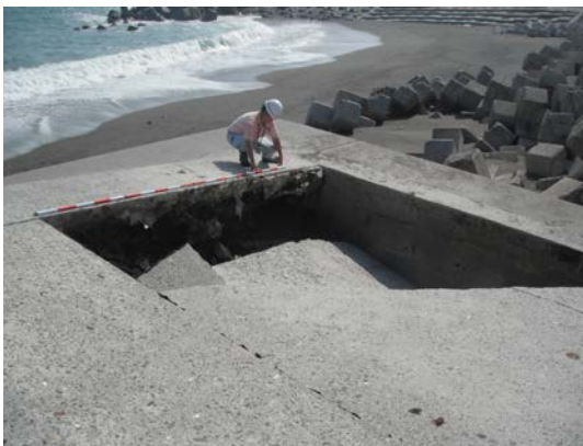
〔戸原海岸被災状況（高知市）〕
