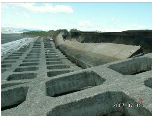
〔吉川海岸被災状況（香南市）〕
