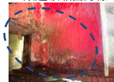
新大森橋の損傷状況
