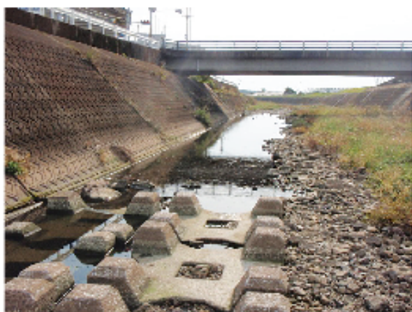
図3-2 へい死地点状況図（安芸土木事務所撮影）
