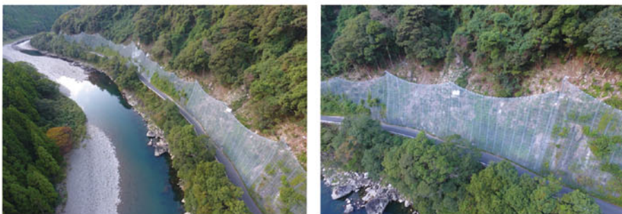
国道493号(安芸郡北川村)
