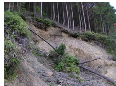
西南豪雨によって斜面が崩壊したヒノキ林地 (土佐清水市三崎川流域)
