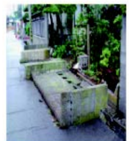
【倒壊したブロック塀】
