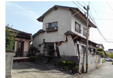
＜地震により被災した住宅＞
