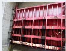
施設の老朽化対策 (甲殿樋門)
