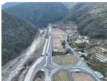
阿南安芸自動車道 北川道路(2-2工区)2.7km 区間 令和7年2月8日開通
