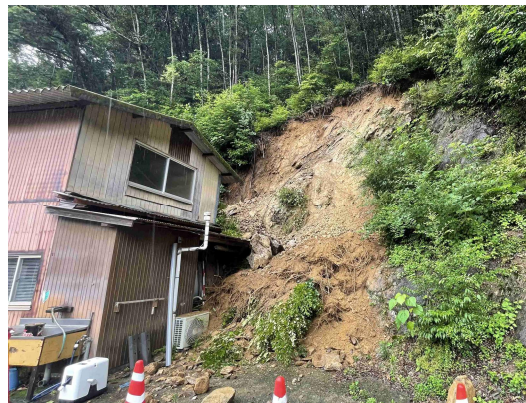
がけ崩れの発生状況 (令和6年6月/四万十市)
