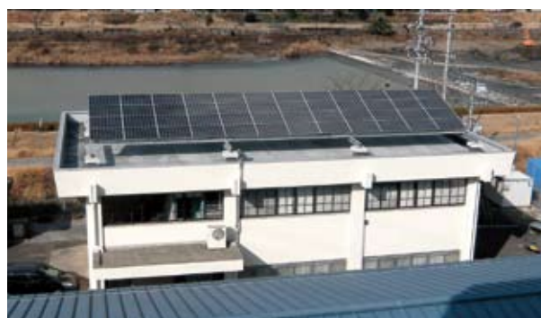
太陽光発電(総合制御所)
