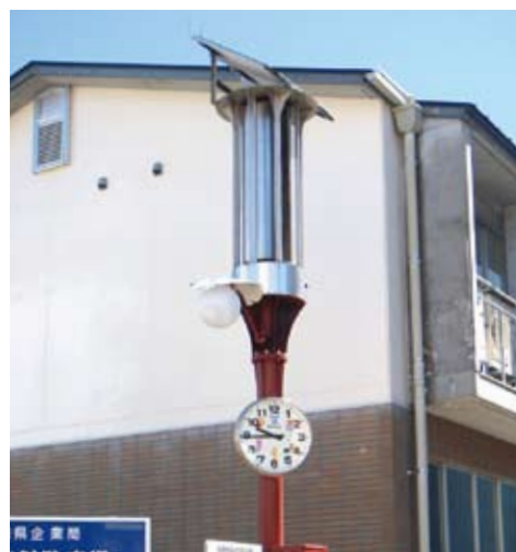
ハイブリッド発電(総合制御所)
