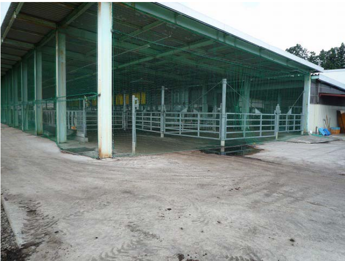
牛舎に設置された防鳥ネット
