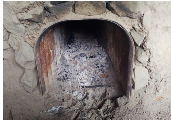
コルゲートフリューム燃烧室
