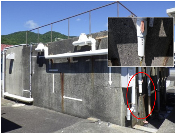
図1 高知県海洋深層水研究所内の濾過槽外観。拡大部は深層水原水の採水部を示す
