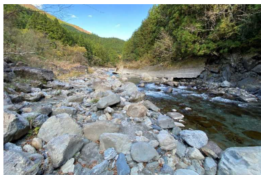
護岸前面の河床の洗掘によって被災した護岸（支川 上葦生川）
