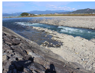
護岸前面の深掘れによって瀬が小規模化した場所（高専前付近）
