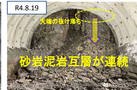
&lt;現地状況&gt;天端の抜け落ち
