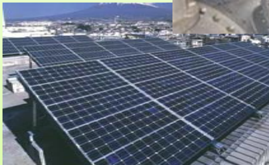
【太陽光発電設備】
