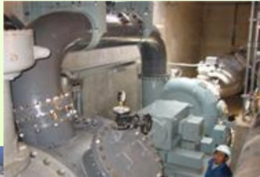
【水力発電設備】
