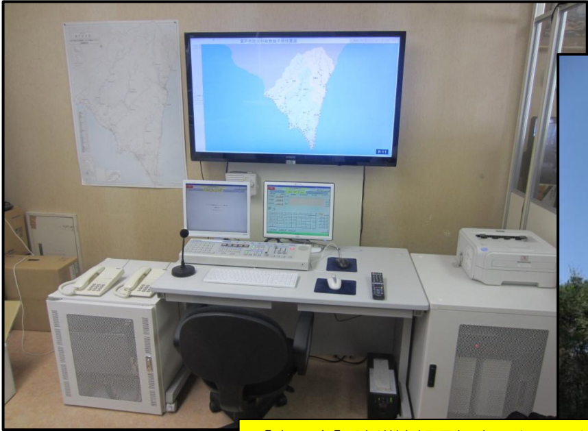
【室戸市】防災情報通信ネットワーク
