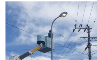
道路照明LED化
